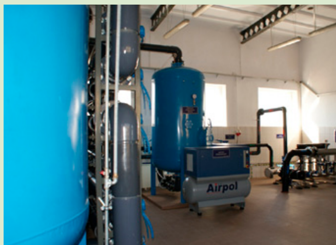
Wnętrze zmodernizowanej Stacji Uzdatniania Wody w Blizanowie Drugim
